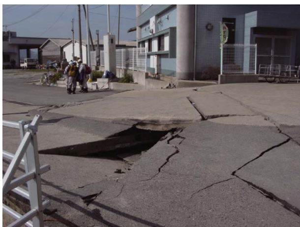
岸壁の亀裂、陥没(福岡市玄界島)
